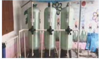
Die neue Wasserfilteranlage in Medapadu
