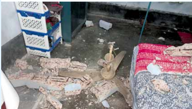
Putz fällt von der Decke in Khalishpur
