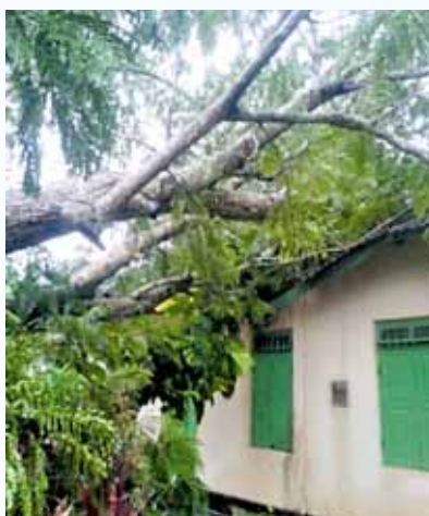
Umgestützter Baum in Pallickal
