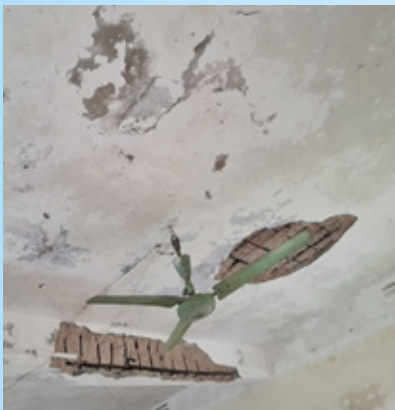
Schäden im Jungenheim in Bangladesch.
